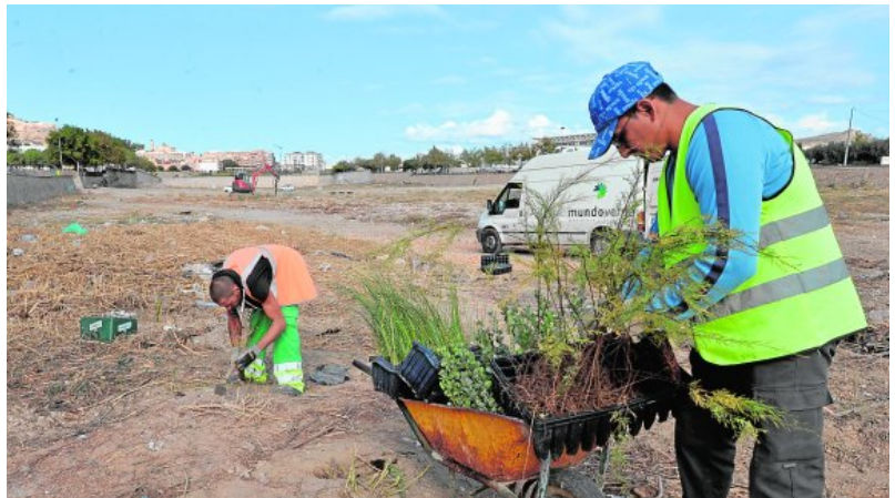
Dos obreros trabajan en la plantación de tamarix canariensis en el cauce del Guadalentín. / Paco Alonso/ agm/
